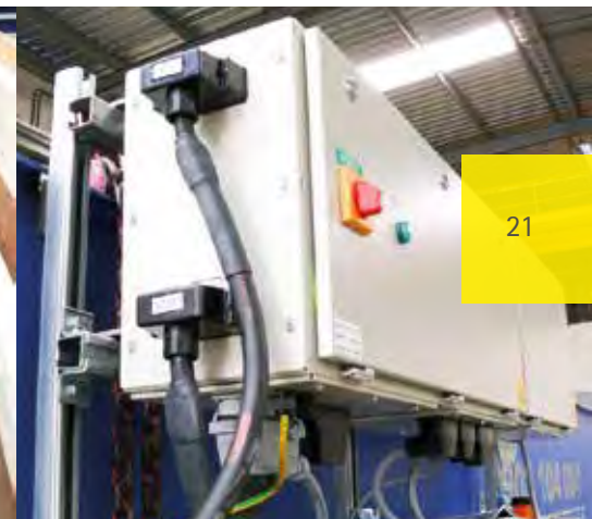
Kranschaltschrank mit Steckverbindungen
